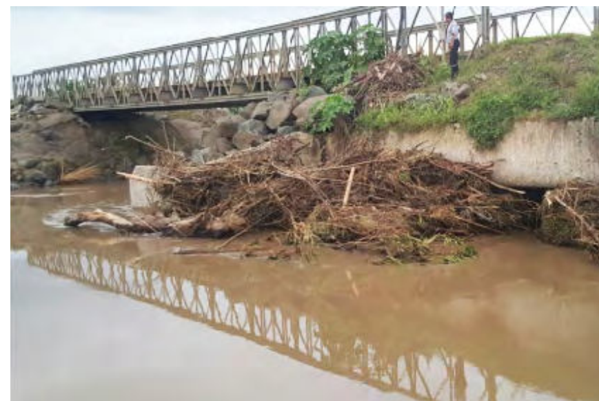
Foto 12: Puente provisional tipo Bailey del río Magro.
