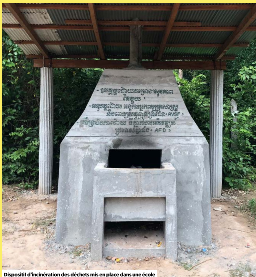
Dispositif d'incinération des déchets mis en place dans une école
